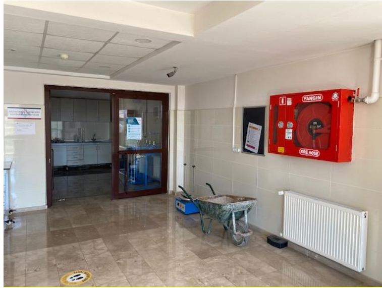
İnşaat Mühendisliği Bölümü Laboratuvarı Yangın Dolabı
